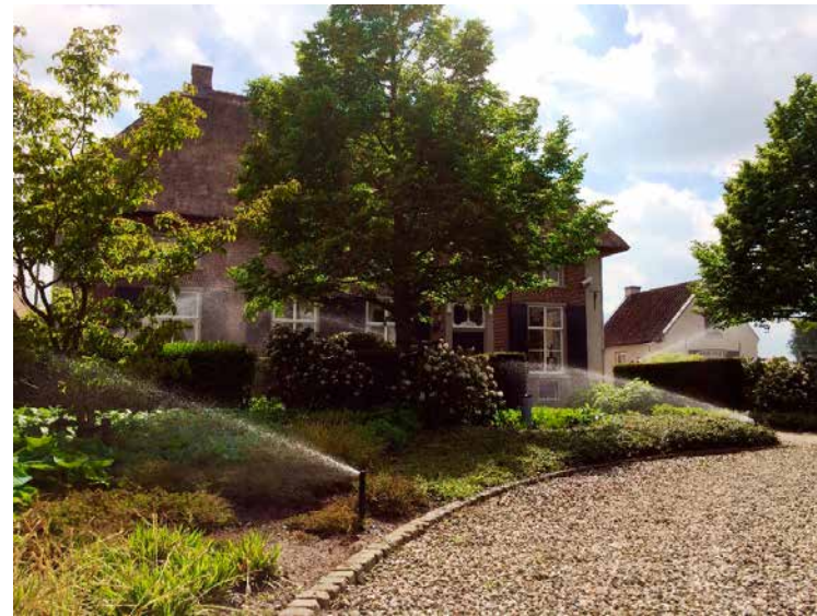
Beregeningsinstallatie particuliere tuin te Maarsse
